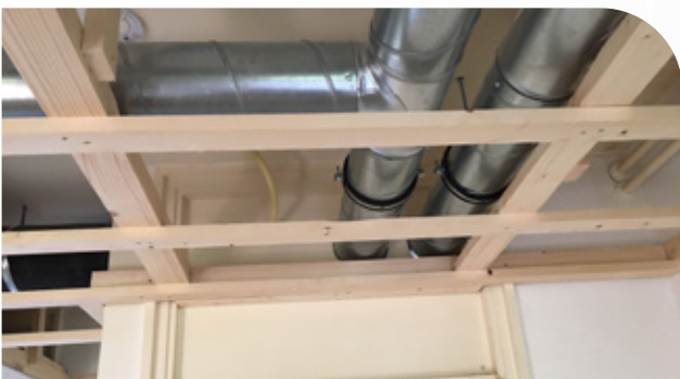
Buizen boven het plafond in de hal. Het plafond op de foto wordt nog dichtgemaakt met gipsplaten. U ziet dan niets meer van de buizen.
