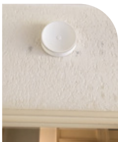
Inblaasventiel (boven de toegangsdeur in de woonkamer)
